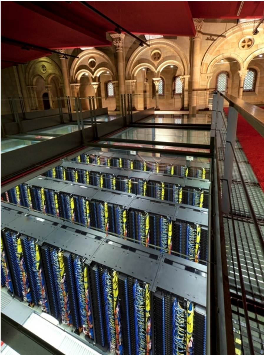
Barcelona Supercomputing Center - Centro Nacional de Supercomputación
